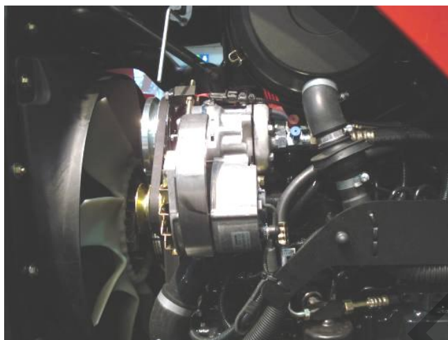
Рисунок 3. – Генераторная установка с дополнительным генератором
