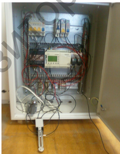
Рисунок 2 – Щит управления с монтажной платой и электрооборудованием
